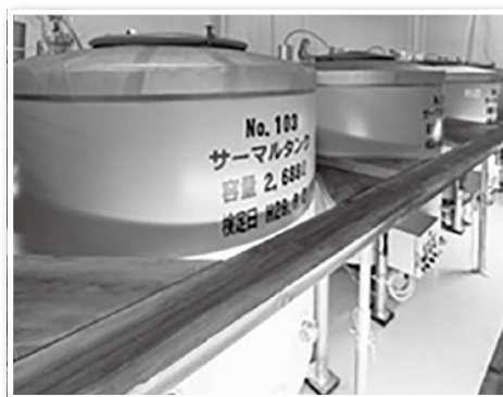
▲サーマルタンク
